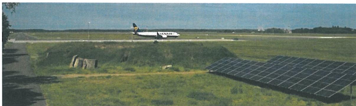
Rysunek 12 Instalacja PV o mocy 50kWp na terenie Portu Lotniczego Bydgoszcz [38]
