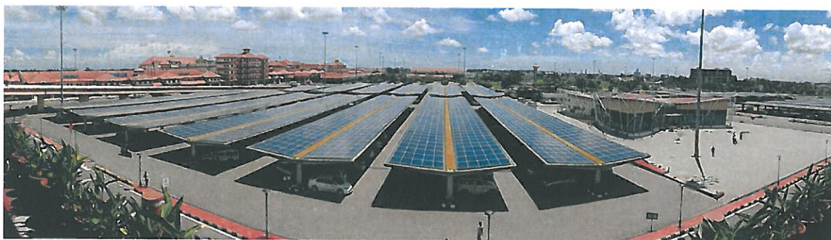
Rysunek 2 Instalacja PV o mocy 2.67 MW w formie Carportów na Cochin International Airport Ltd. [33]
