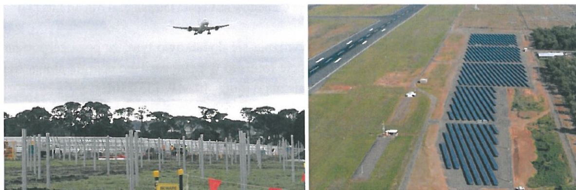
Rysunek 5 Instalacja PV podczas budowy na lotnisku w Melbourne [14] oraz na międzynarodowym lotnisku w Darwin [19]
