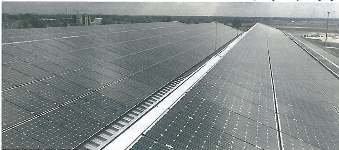
Rysunek 11 Instalacja PV na dachu terminala T1 na lotnisku im. Chopina w Warszawie [43]
